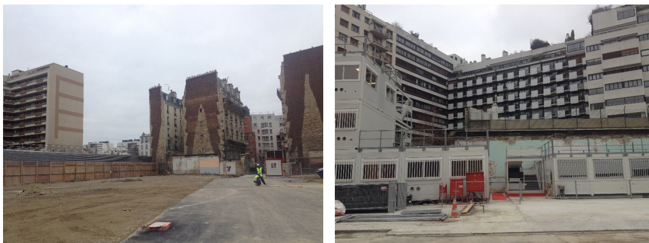
Figure 2 : Photographie de gauche : site du projet, emplacement du bâtiment C. Photographie de droite : emplacement du bâtiment A, en lieu et place des bungalows. Source : rapporteurs
